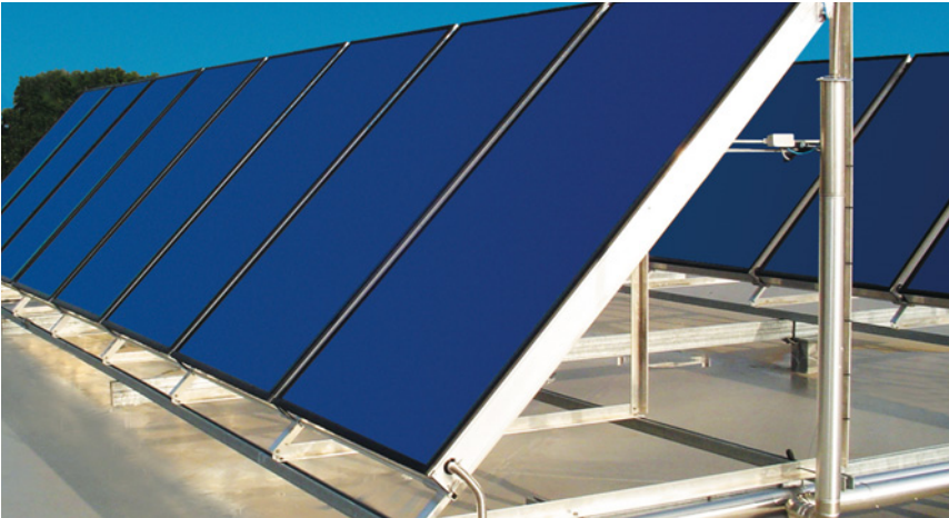
Lapos tetőre szerelt berendezés 16 kollektorral
