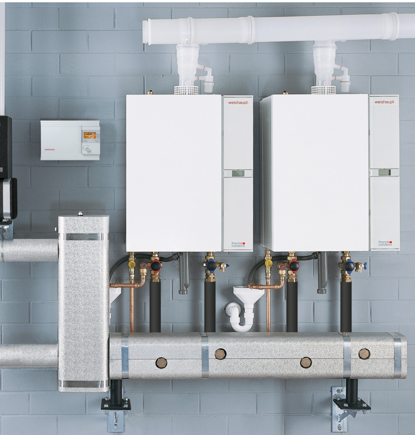
Egy 240 kW teljesítményű Thermo Condens kaszkádnál a minimális modulációs teljesítmény 5%-nál kezdődik, amely azután az igényektől függően fokozatmentesen egészen a teljes teljesítményig növelhető.
